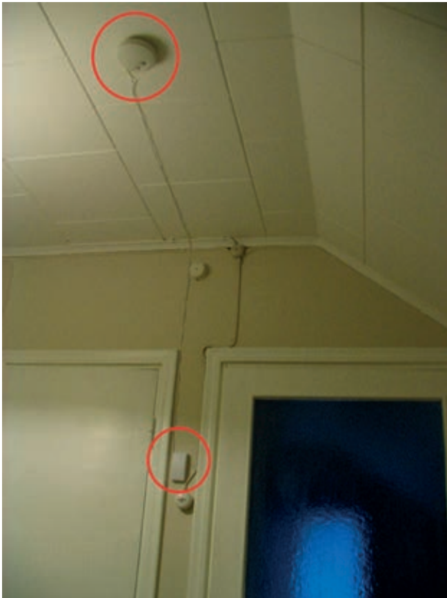
Kuvassa on katossa palovaroitin, josta on vedetty jatkojohto kattoa pitkin seinälle ja sieltä edelleen alas. Palovaroittimen paristokotelo on asennettu ovenpieleen valokytkimen korkeudelle.
